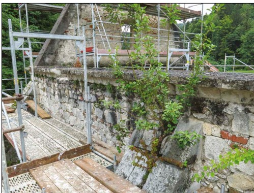
Vrhnji del južne stene med prvim in drugim opornikom, stanje pred posegi
