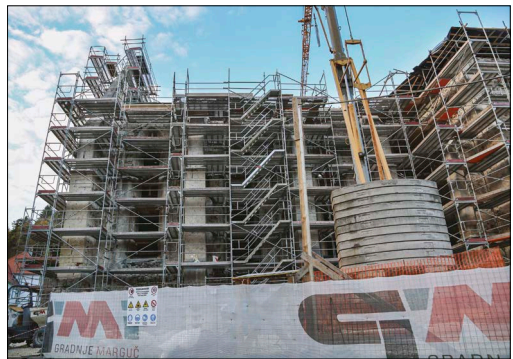
Pogled na zidovje južnega dela nekdanje samostanske cerkve med aktualnimi gradbenimi deli, 2020 (foto: Igor Sapač)
