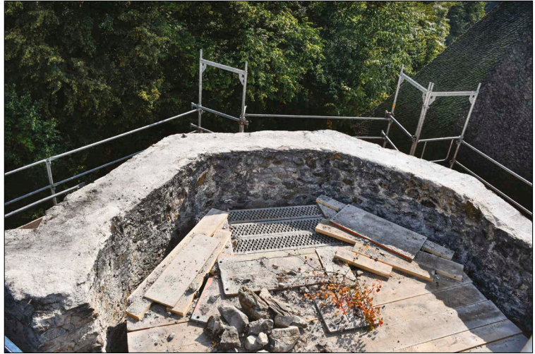
Poligonalni zaključek Otokarjeve kapele po odstranitvi betonskega strešnega venca, pogled proti vzhodu
